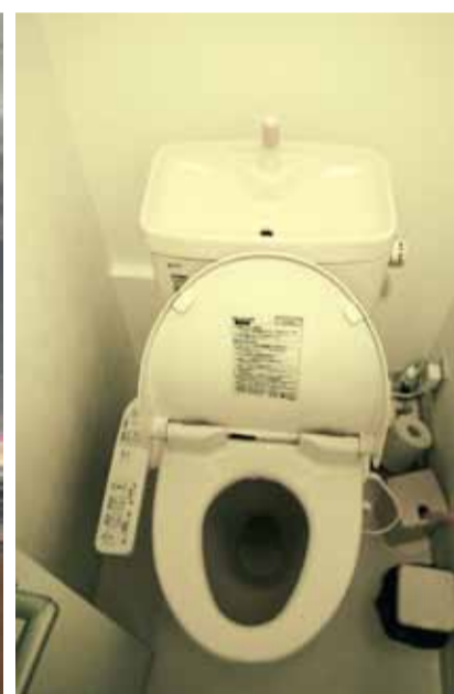
NÁDRŽKA TĚTO TOALETY JE NAPOUŠTĚNA PŘES JAKÉSI UMYVALO. VODA JE TEDY POUŽITA DVAKRÁT.
